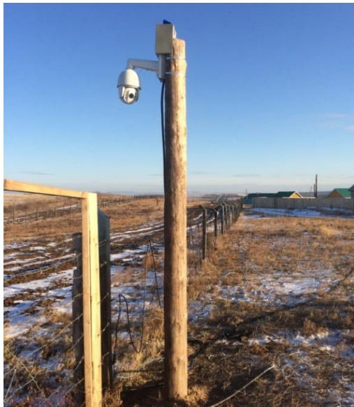
Зураг. 4. IP камерыг байрлуулсан байдал
